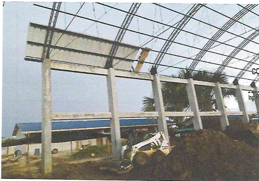
FOTO N°12: Vista del techado de la losa deportiva en la obra "Mejoramiento y Equipamiento del servicio Educativo N° 62200 Barrio Carabanchel - San Lorenzo, Distrito Barranca. Provincia Datem Del Marañón - Loreto".
