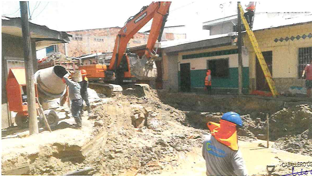
FOTOGRAFÍA 01: INICIO DE EXCAVACIÓN A NIVEL DE SOBRE EXCAVACIÓN EN LA CA. BELAUDE TERRY
