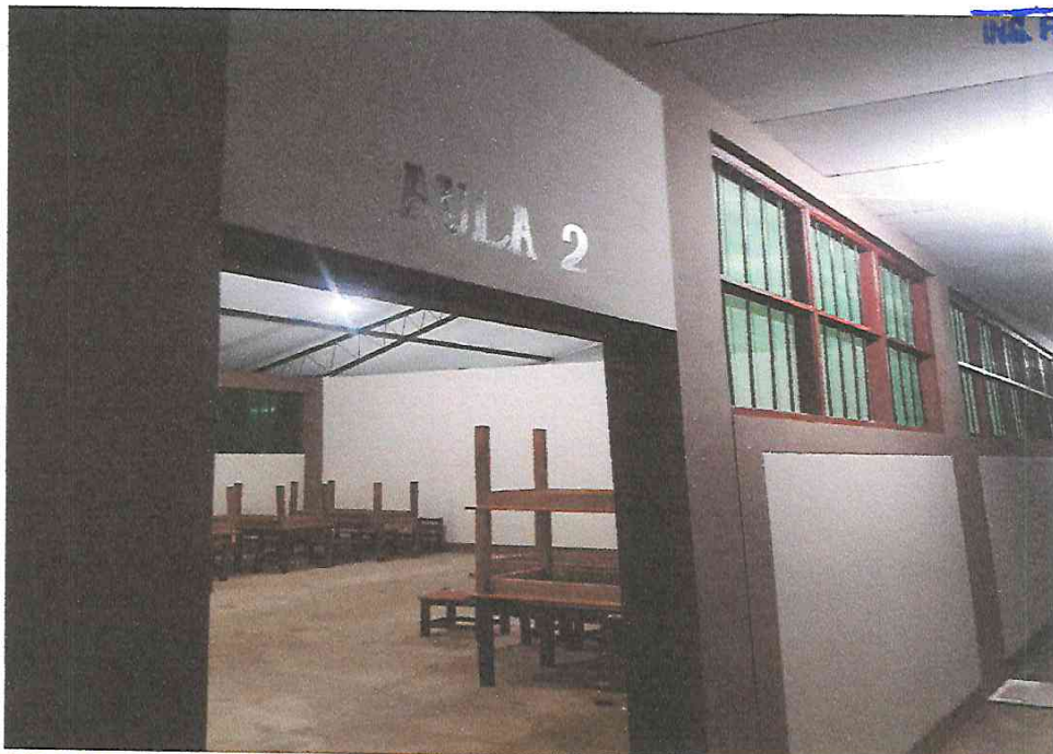
FOTO N°15: SE MUESTRA EL FUNCIONAMIENTO DE LA LUMINARIAS DE LAS AULAS Y VEREDA DE LA I.E
