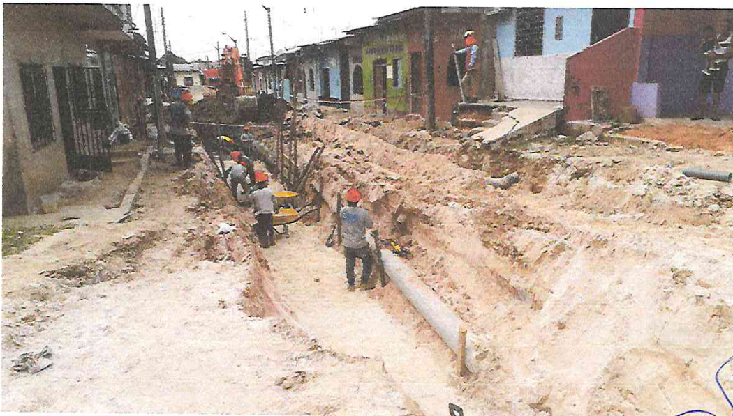
FOTOGRAFÍA 15: ENTIBADO Y COLOCACION DE CAMA DE ARENA EN ALCANTARILLA EN LA CALLE PAMPACHICA
