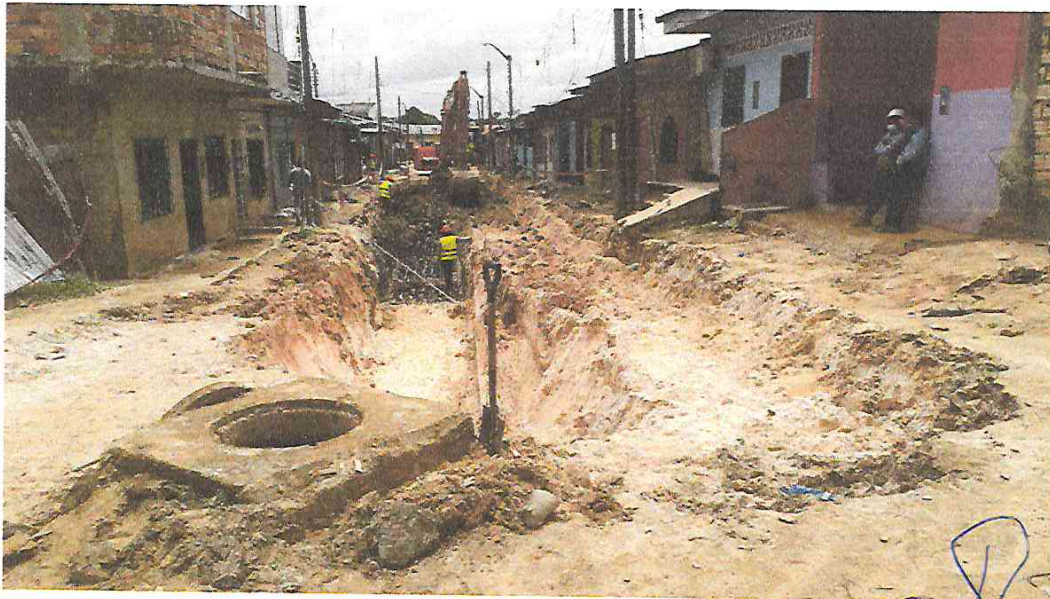
FOTOGRAFÍA 13: PERFILADO Y NIVELACION DE FONDO DE CANAL DE ALCANTARILLA EN LA CALLE PAMPACHICA
