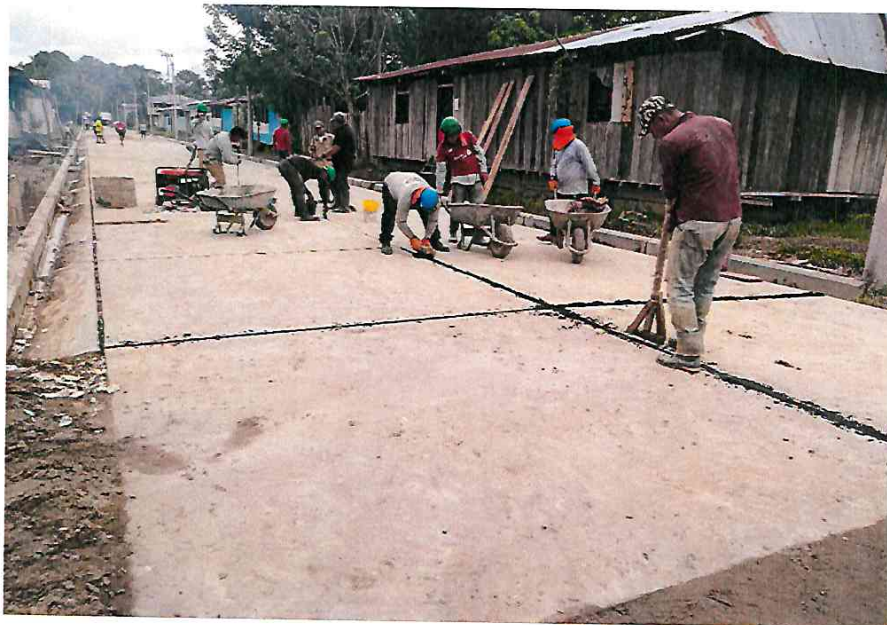
- LIMPIEZA DE JUNTAS LONGITUDINALES, CONTRACCION Y DE DILATACION PARA LUEGO SER LLENADAS CON ASFALTO, COMO SE PUEDE APRECIAR EN LA IMAGEN.
