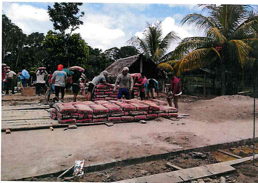
- LLEGADA DE MATERIALES A LA LOCALIDAD DE IBERIA, DONDE SE UBICA LA OBRA EN EJECUCION, Y POSTERIORMENTE TRANSPORTADA A ALMACEN.
