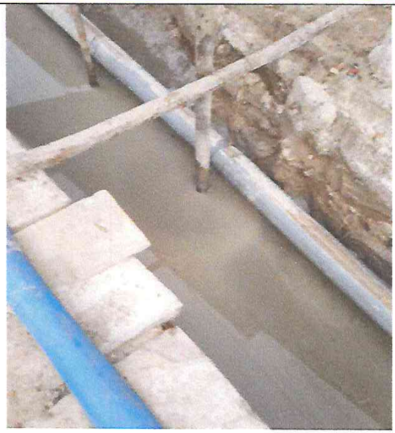
Colocación e instalación de drenaje auxiliar con tubería de PVC 6" en calle Triangulo de Bermuda.
