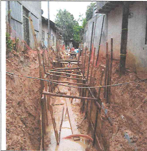
Excavación de zanja y entibado de paredes en calle prolongación Jose Galvez.
