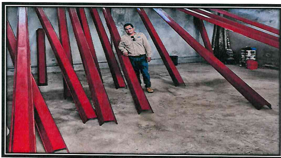
4.0 EN LA FOTO SE APRECIA LA HABILITACION DE LAS CORREA METALICA TIPO CANALES "U" DE 4" DEL TECHO EN EL MODULO LOSA DEPORTIVA.
