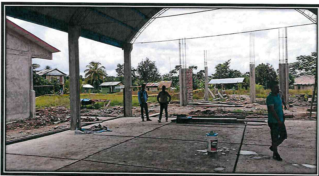
6.00 EN LA FOTO SE PUEDE APRECIAR LA CONSTRUCCION DE PISOS DE MORTERO S/COLOR, E=2.5 CM BRUÑADO.
