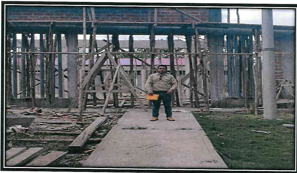
4.0 EN LA FOTO SE APRECIA LA CONSTRUCCION DE VEREDA DE ACCESOS DE MORTERO f'c= 175 kg/cm 2 FROTACHADO DE e= 4''
