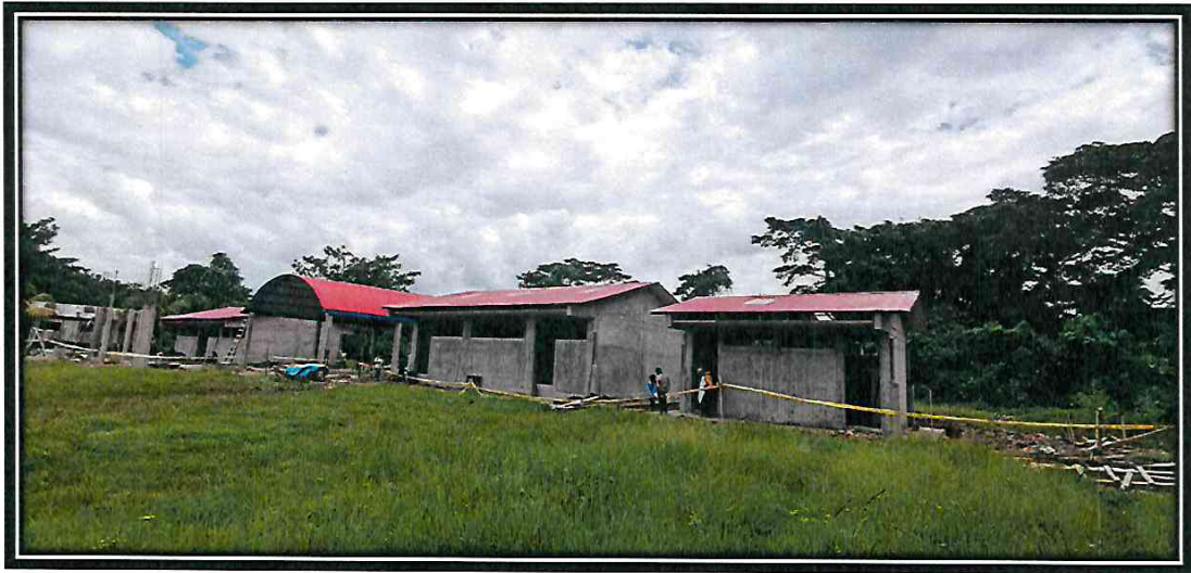
3.00 EN LA FOTO SE PUEDE APRECIAR LA COLOCACION DE COBERTURA DE CALAMINA ONDULADA ZINC 1.80M X 0.83M X 0.26 mm Y AL MISMO TIEMPO TRASLÚCIDAS EN LOS MODULOS AULA + SS.HH Y SUM COMEDOR.
