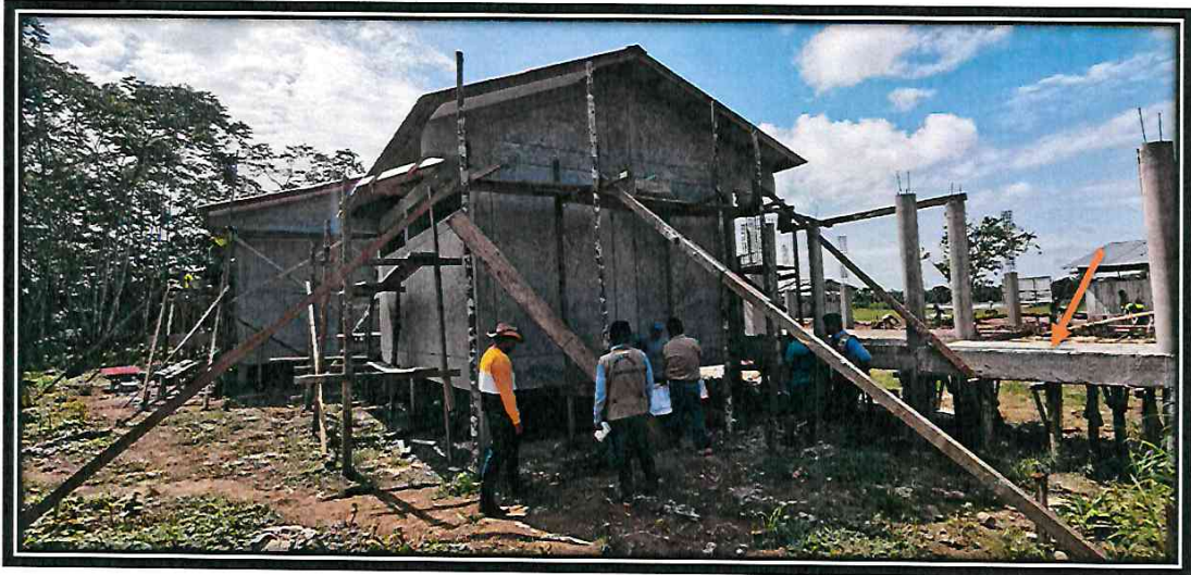
3.0 EN LA FOTO SE APRECIA LA CONSTRUCCION DE VEREDA DE ACCESOS DE MORTERO f'c= 175 kg/cm 2 FROTACHADO DE e= 4''
