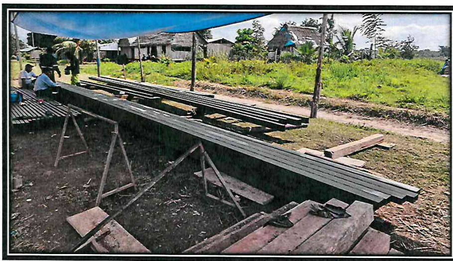
3.0 EN LA FOTO SE APRECIA LA HABILITACION DE LA ESTRUCTURA METALICA PARA LA ARMADURA DEL TECHO EN EL MODULO LOSA DEPORTIVA.
