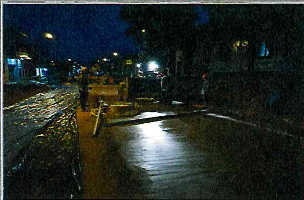
Vista: Vaceo de solado para losa de rodadura, carril derecho - Ca. San Roman (Ca. Libertad / Ca. Atahualpa)
