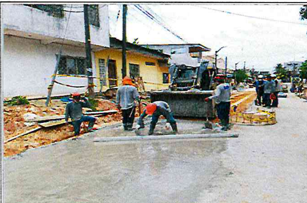
Vista: Vaceo de solado para losa de rodadura, carril izquierdo - Ca. San Roman (Ca. Libertad / Ca. Atahualpa)
