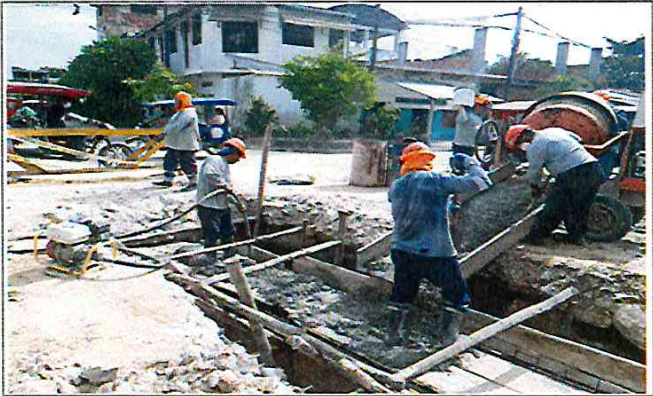
Vista: Vaceo de muro de canal rectangular - Empalme de Pje. Independencia I / Ca. Atahualpa
