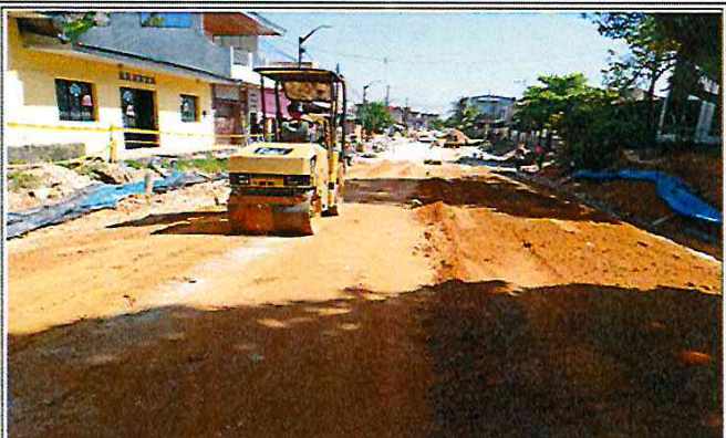
Vista: Compactación de material A-2-4 para Sub Base - Ca. San Roman ( Ca. Libertad/ Ca. Atahualpa)
