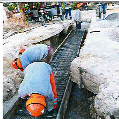
Vista: Habilitación de acero para losa de techo de canal - Ca. San Roman c/ Ca. Atahualpa
