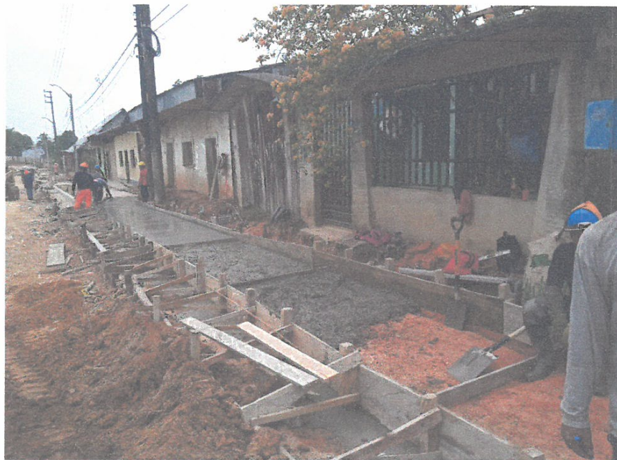
VACEO DE VEREDA EN LA CALLE 6 DE FEBRERO, LADO IZQUIERDO.
