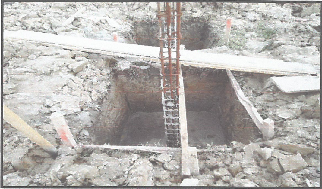
FOTO N°01: EN LA IMAGEN SE MUESTRA TRABAJOS DE MORTERO F'c= 210 KG/CM2 EN ZAPATAS
