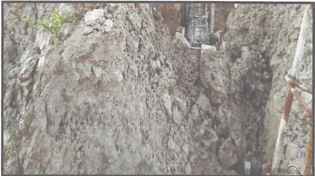
FOTO N°02: EN LA FOTO SE PUEDE OBSERVAR TRABAJOS DE EXCAVACIÓN DE ZANJAS PARA VIGAS DE CIMENTACIÓN
