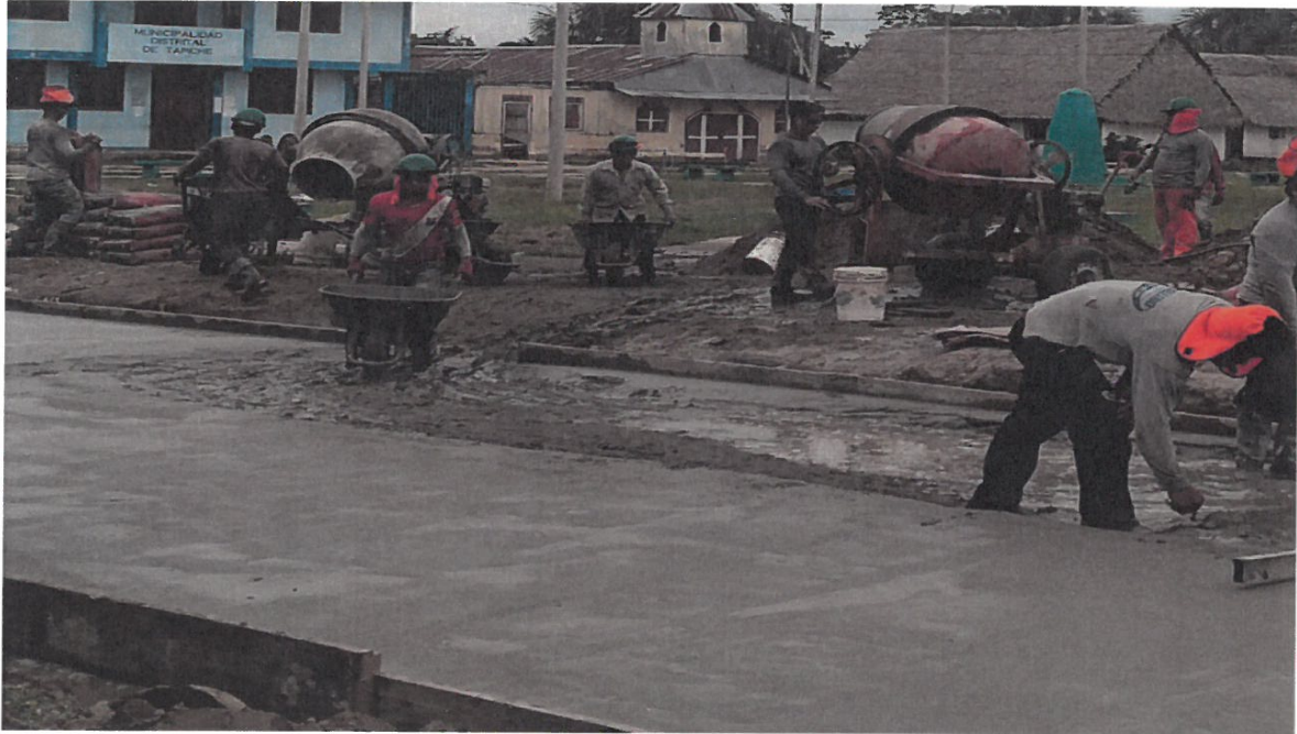
Imagen 5 Vaceo de losa de rodadura: los trabajadores cuentan con gafas de seguridad para evitar lesiones oculares al momento de recoger la mezcla del trompo
