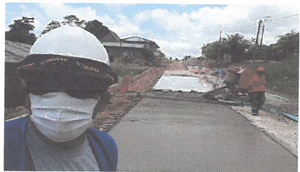
VACIADO DE CONCRETO F'C=210 KG/CM2, EN JR. 2 DE MAYO ENTRE JR PROGRESO Y JR. CONTAMANA
