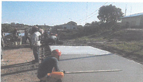
VACIADO DE CONCRETO F'C=210 KG/CM2, EN JR. 2 DE MAYO ENTRE JR. REQUENA Y JR. LIBERTAD
