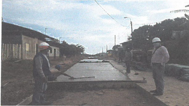
VACIADO DE CONCRETO F'C=210 KG/CM2, EN JR. 2 DE MAYO ENTRE JR LIBERTAD Y JR. MARIATEGUI
