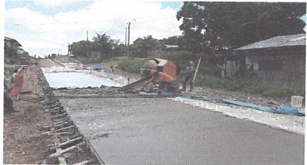
VACIADO DE CONCRETO F'C=210 KG/CM2, EN JR. 2 DE MAYO ENTRE JR PROGRESO Y JR. CONTAMANA
