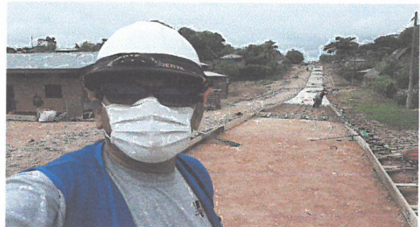
ENCOFRADO PARA PAVIMENTO, EN JR. 2 DE MAYO ENTRE JR. CONTAMANA Y JR. SAN JUAN
