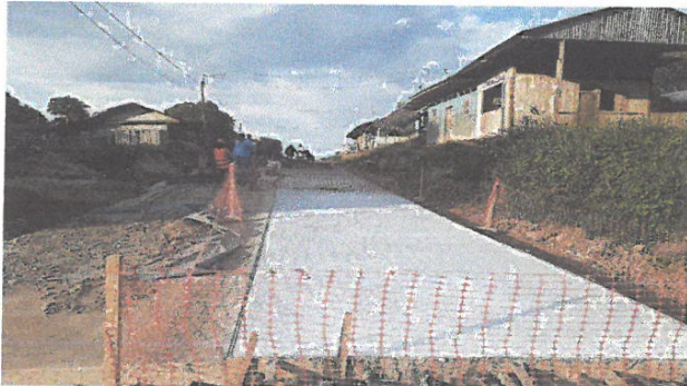
VACIADO DE CONCRETO F'C=210 KG/CM2, EN JR. 2 DE MAYO ENTRE JR MARIATEGUI Y JR. PROGRESO
