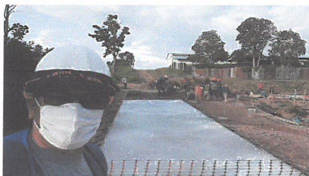
VACIADO DE CONCRETO F'C=210 KG/CM2, EN JR. 2 DE MAYO ENTRE JR. CONTAMANA Y JR. SAN JUAN
