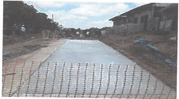
VACIADO DE CONCRETO F'C=210 KG/CM2, EN JR. 2 DE MAYO ENTRE JR MARIATEGUI Y JR. PROGRESO
