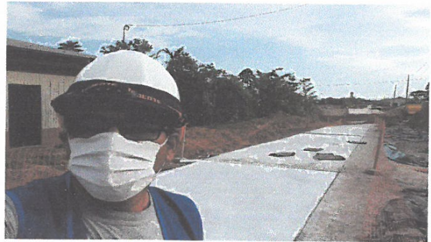
VACIADO DE CONCRETO F'C=210 KG/CM2, EN JR. 2 DE MAYO ENTRE JR LIBERTAD Y JR. MARIATEGUI
