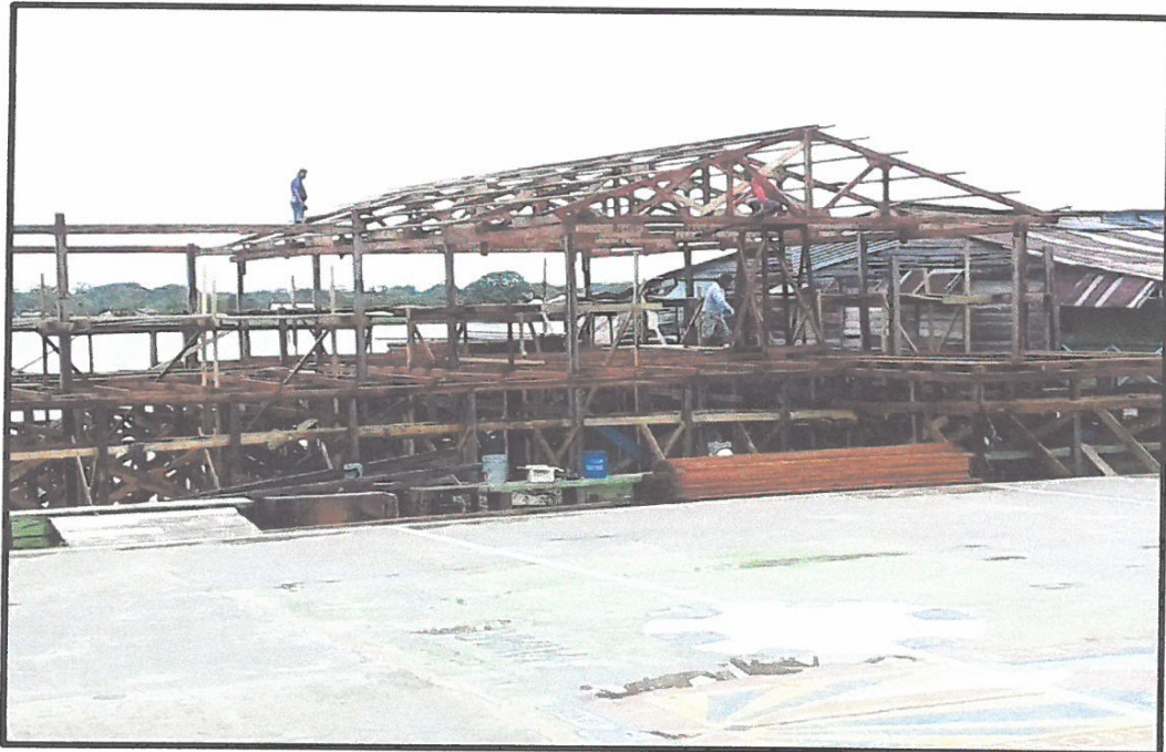
EN LA VISTA PODEMOS APRECIAR LOS TRABAJOS DE OBRAS PROVISIONALES (OFICINAS ADMINISTRATIVAS, COMEDOR, ALMACEN, GARITA DE VIGILANCIA, SS.HH) REALIZADOS EN OBRA.
