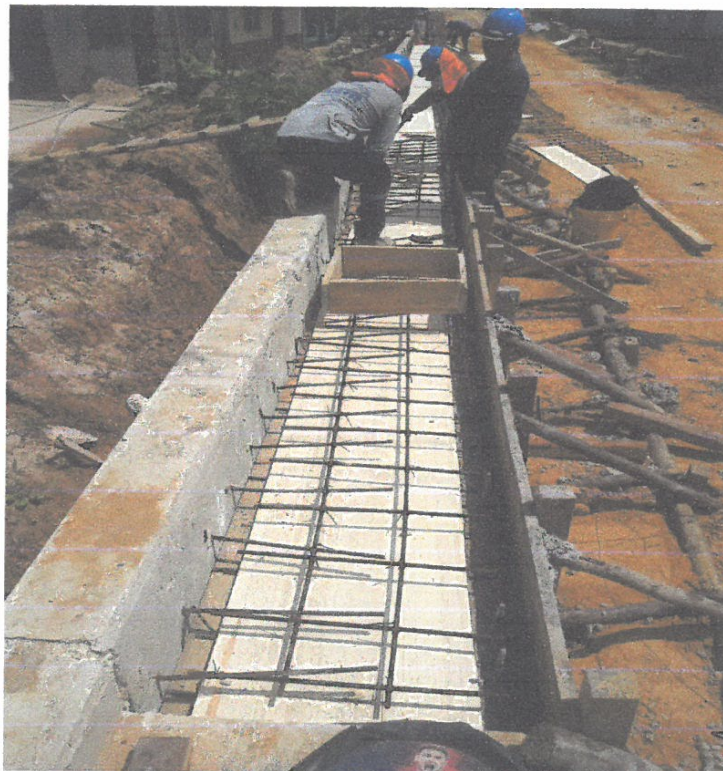
ENCOFRADO DE TAPA DE CUNETTA EN LA CALLE CONDAMINE CUADRA 03, LADO DERECHO.
