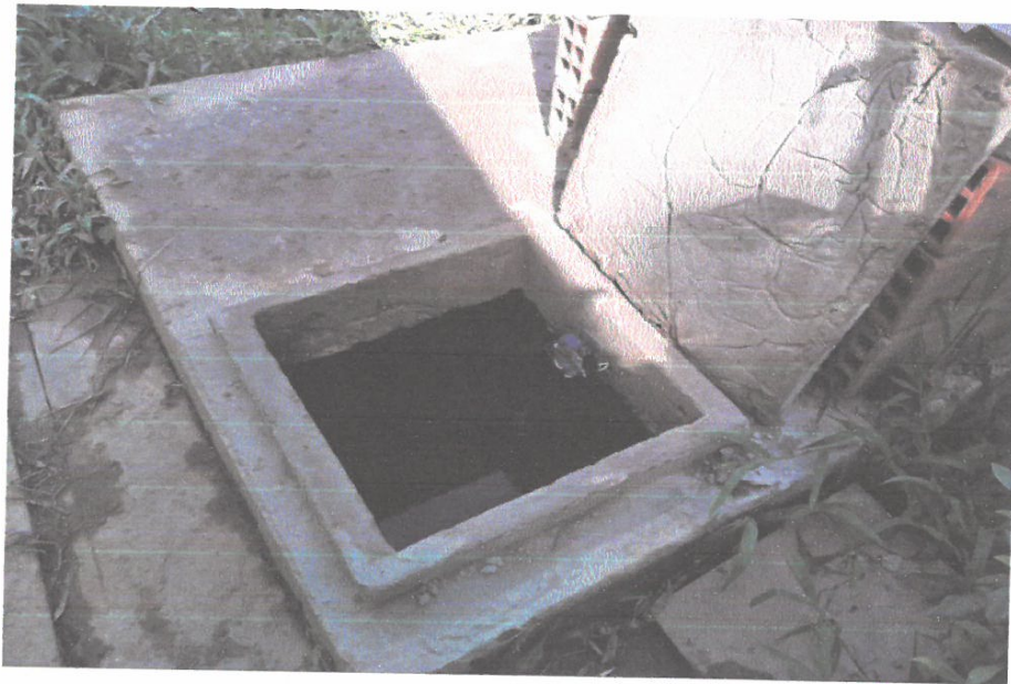
POZA DE ALMACENAMIENTO DE AGUA.
