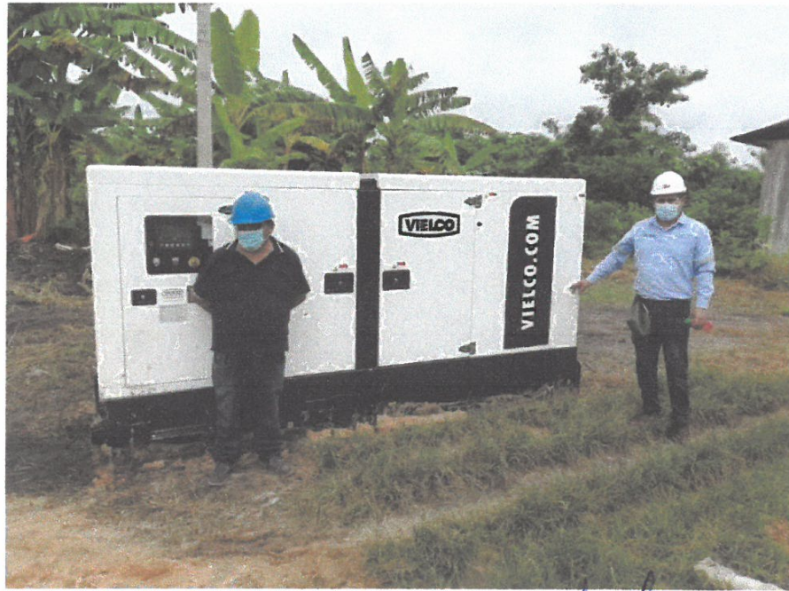
VISTA DE RESIDENTE CON INSPECTOR REVISANDO EL GRUPO ELECTROGENO
