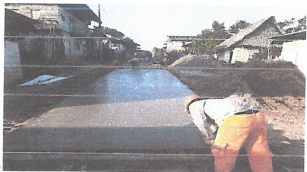
VACIADO DE CONCRETO F'C=210 KG/CM2, EN JR. 2 DE MAYO, ENTRE JR. TRUJILLO Y JR. ALFONSO UGARTE
