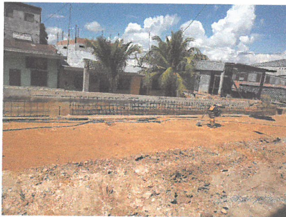
ENCOFRADO DE PISO DE CUNETA EN LA CALLE TARATA CUADRA 07, LADO DERECHO
