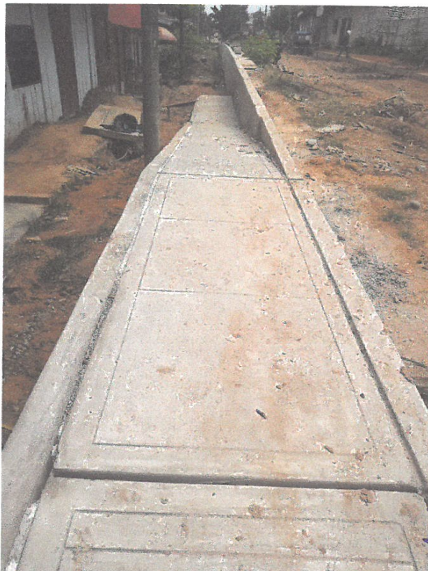
ACABADO DE VEREDA Y RAMPA EN LA CALLE CONDAMINE CUADRA 03, LADO DERECHO.
