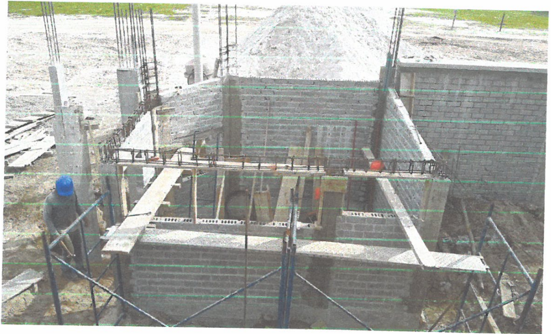
FOTO N° 13. Otra vista específica del avance de los trabajos en caseta de control de acceso a la Institución Educativa
