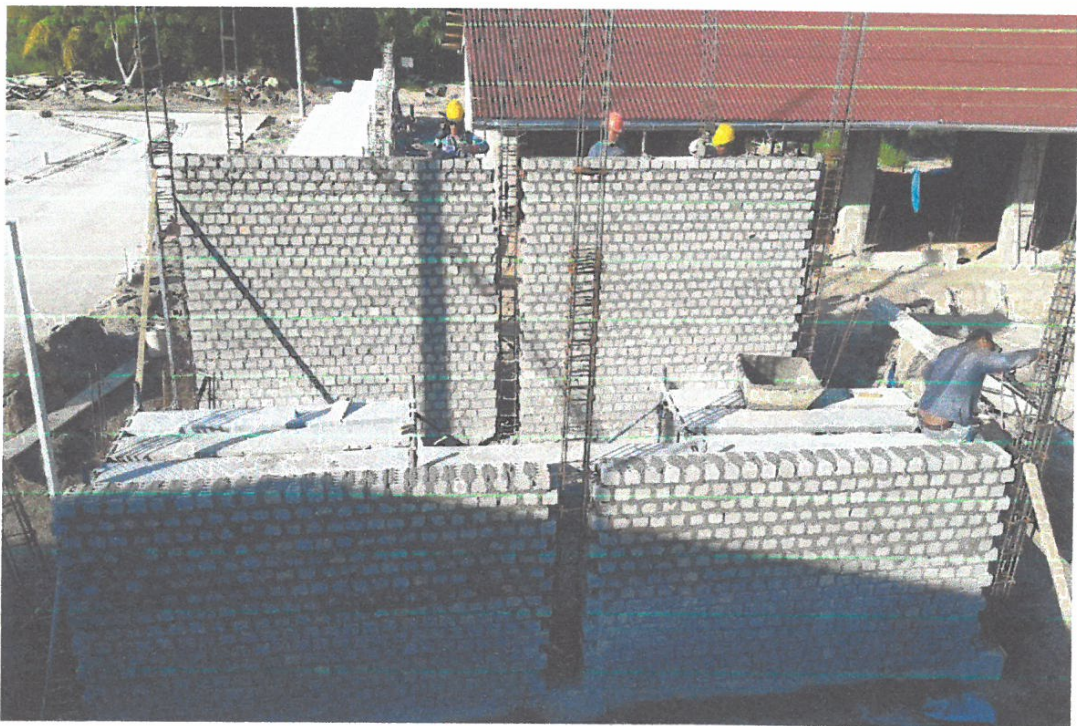
FOTO N° 04.- Asentado de muro de ladrillos en aparejo de cabeza; la vista precisa el desarrollo de los trabajos que viene desplegándose en uno de los módulos de SS.HH.
