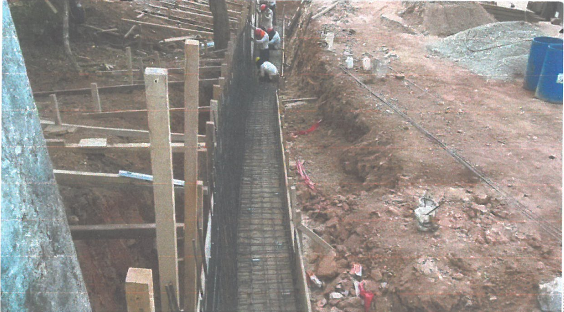
FOTO N° 08: EN LA VISTA SE OBSERVA AL PERSONAL HACIENDO EL TRABAJO DE ANCLADO DE ACERO PARA MURO DE CONTENCIÓN.
