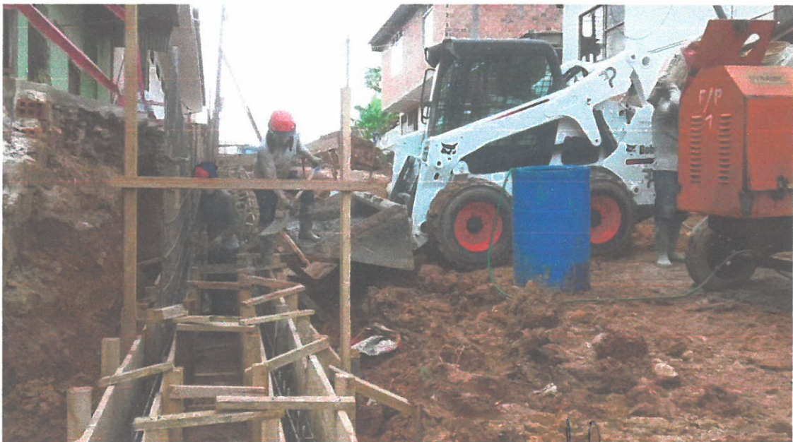
FOTO N° 05: EN LA VISTA SE OBSERVA AL PERSONAL REALIZANDO EL VACEO EN SARDINEL.
