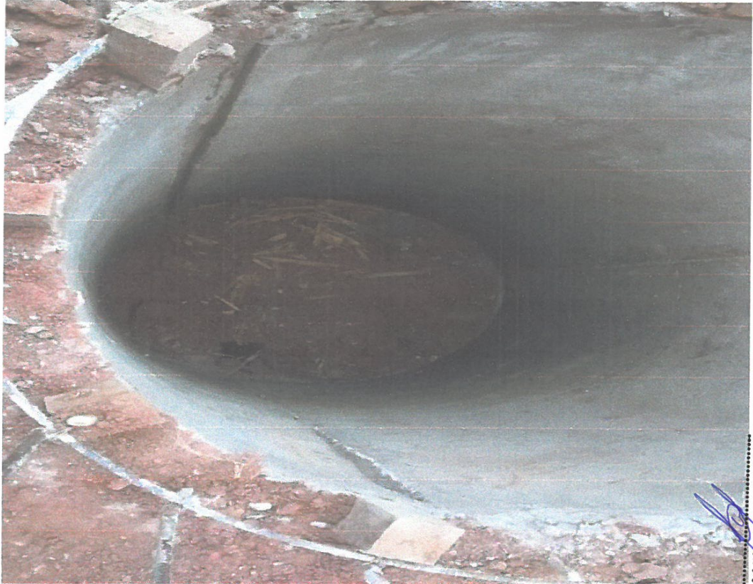
FOTO N° 10: EN LA VISTA SE OBSERVA EL BUZON VACEADO.
